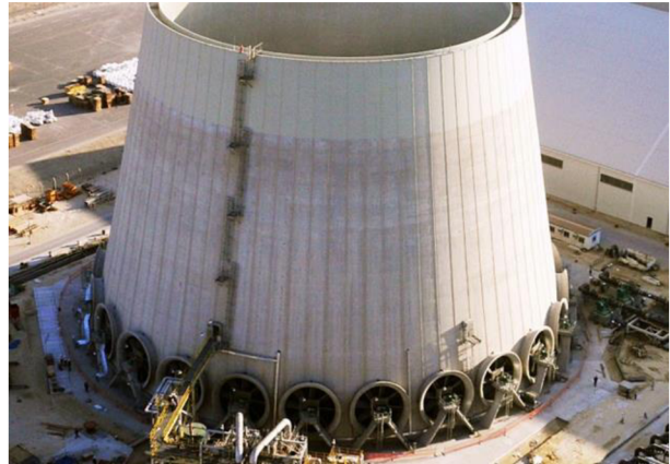
Obr. 4.1.5: Věž se spodními ventilátory [g]
