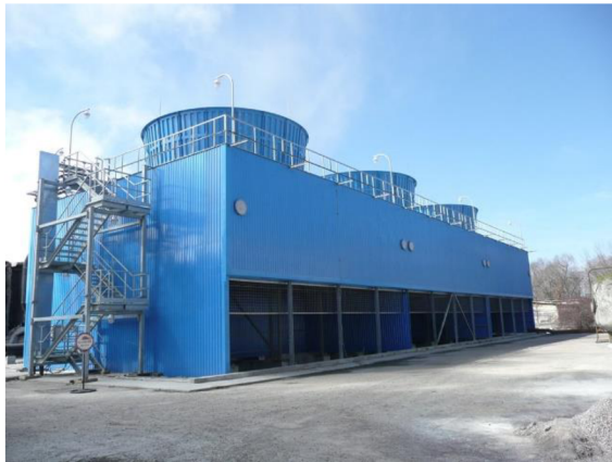
Obr. 4.1.4: Věž s horními ventilátory [e]
