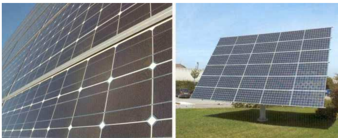
Obr.č. 7. Solární panely. Převzato z jednotlivých dokumentů internetu
