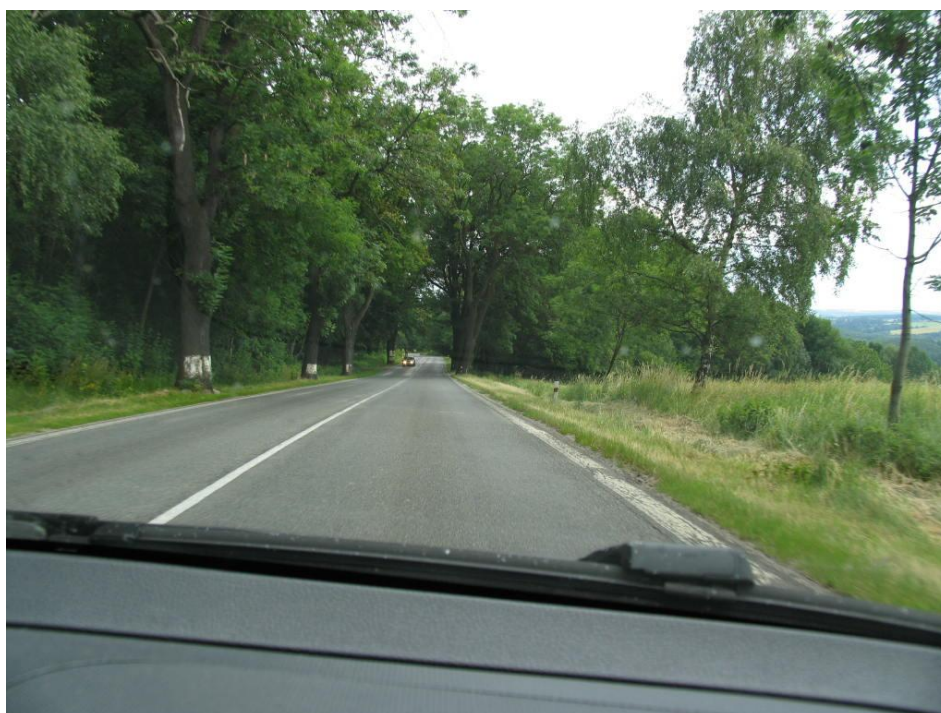
Obrázek č. 30: Příklad nevhodně rostoucí silniční vegetace na hraně sil. č. I/3.
