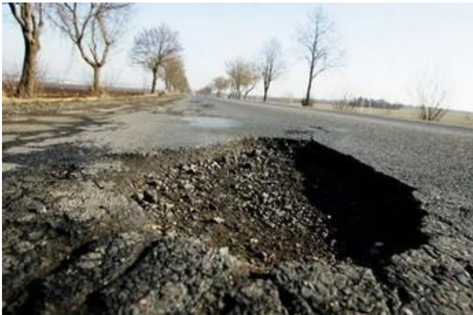
Obrázek č. 6: Příklad nevyhovujícího stavebního stavu krytu silnice.
