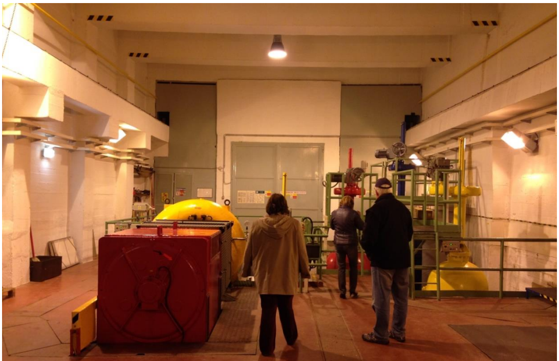
Obr. 11 . malá vodní elektrárna (foto autor, 3. 10. 2014)
