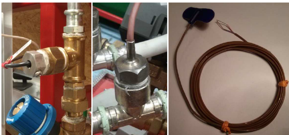
Obrázek 26 Instalace termočidla průtokoměru, odporového čidla PT100 v trubce, nalepovací termočlánek
