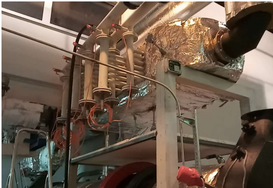
Obr. 7: Fotografie sestavy odvodu spalin na zkušebně Ústavu procesního inženýrství.
