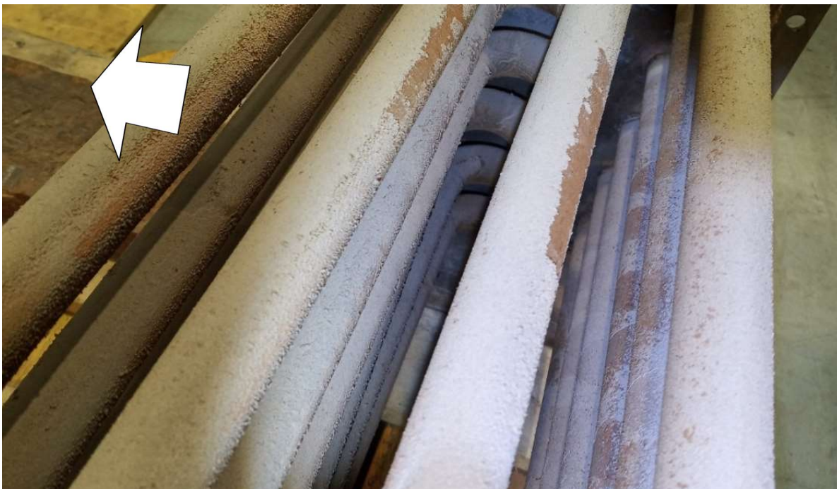
Obr. 50: Druhý trubkový svazek. Šipka označuje směr proudu spalin.
