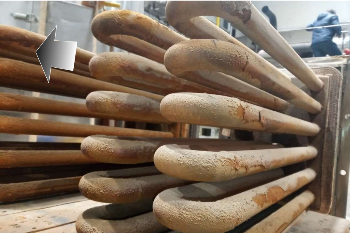
Obr. 49: První trubkový svazek. Šipka označuje směr proudu spalin.
