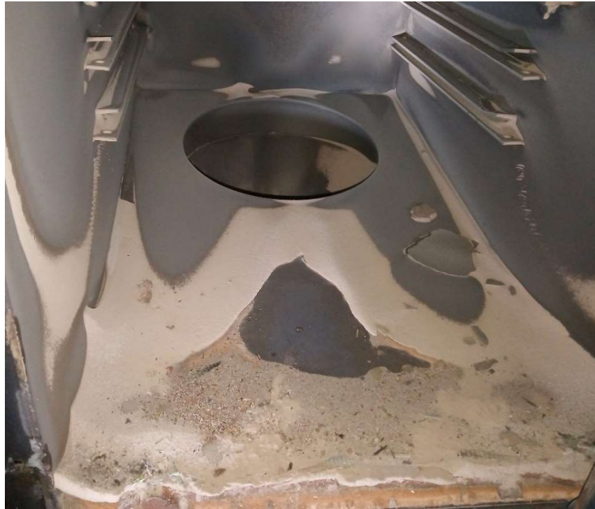
Obr. 19: Sypký nános na dně usazovací komory.
