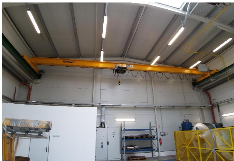
Obrázek 30 Mostový jeřáb Remo CZ 5t.
