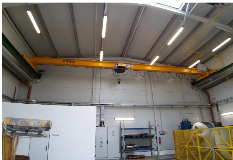
Obrázek 30 Mostový jeřáb Remo CZ 5t.
