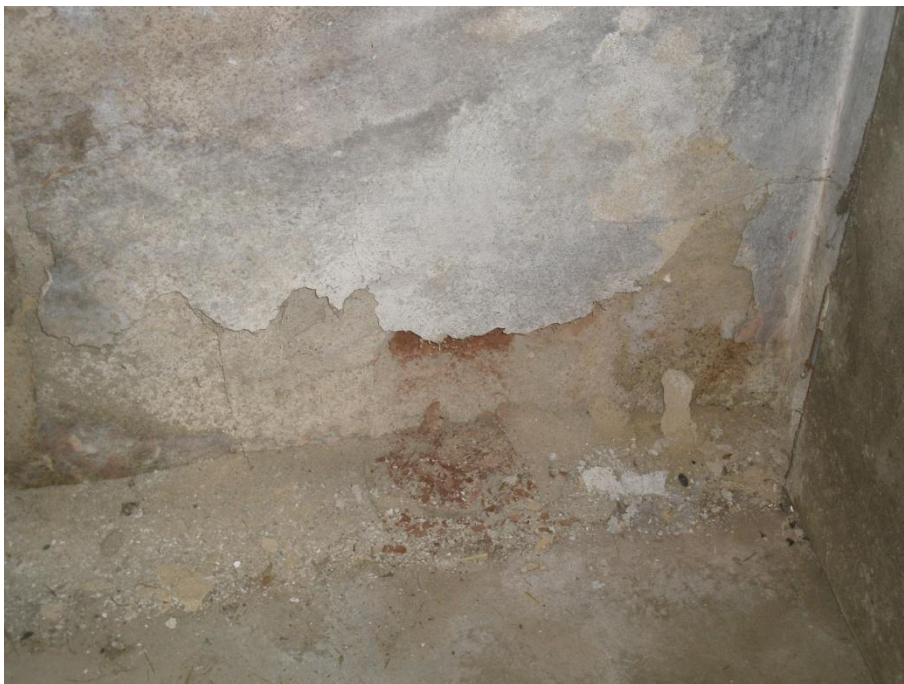
Foto 6: Odpadávající omítka (pohled u podlahy, vedle chodby) ve „staré kuchyni“
