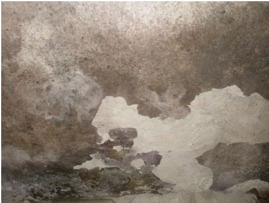
Foto 4: Vlhké mapy a odpadávající omítka (pohled u podlahy) ve spíži
