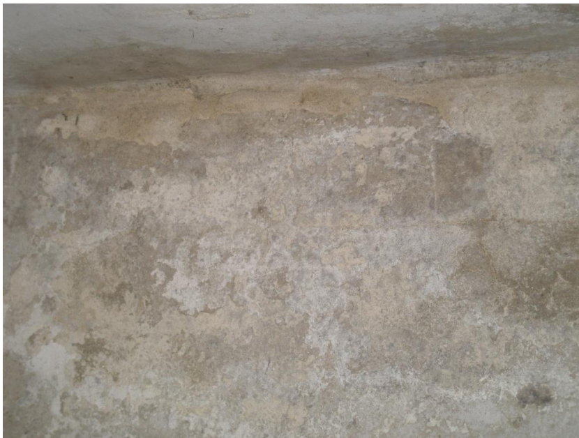
Foto 8: Rozsáhlé vlhkostní mapy (pohled u stropu, vedle spíže) ve „staré kuchyni“
