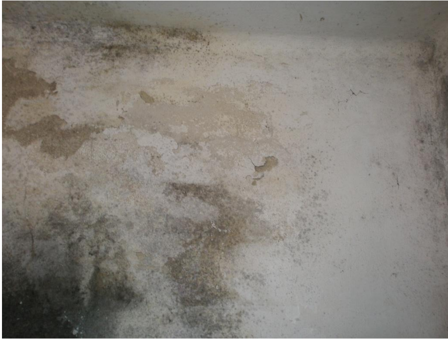
Foto 5: Vlhké mapy a odpadávající omítka (pohled u stropu, vedle chodby) ve „staré kuchyni“
