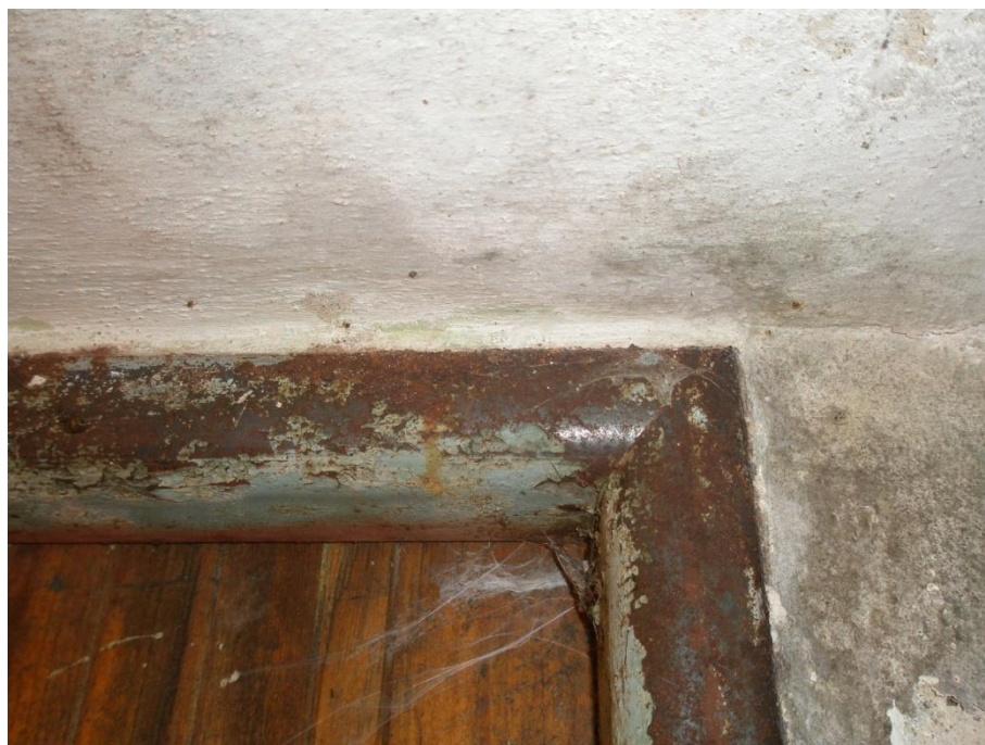
Foto 1: Koroze zárubní u sklepa na brambory
