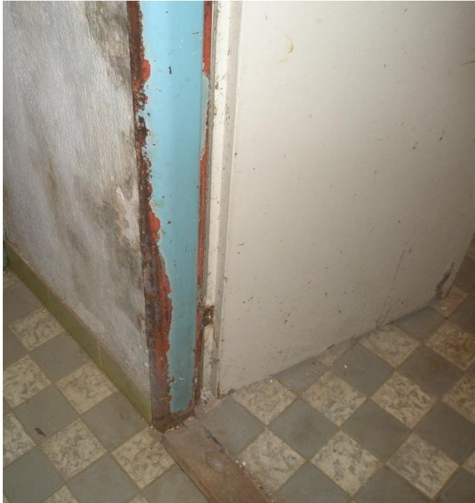
Foto 3: Koroze zárubní u vchodu do prádelny
