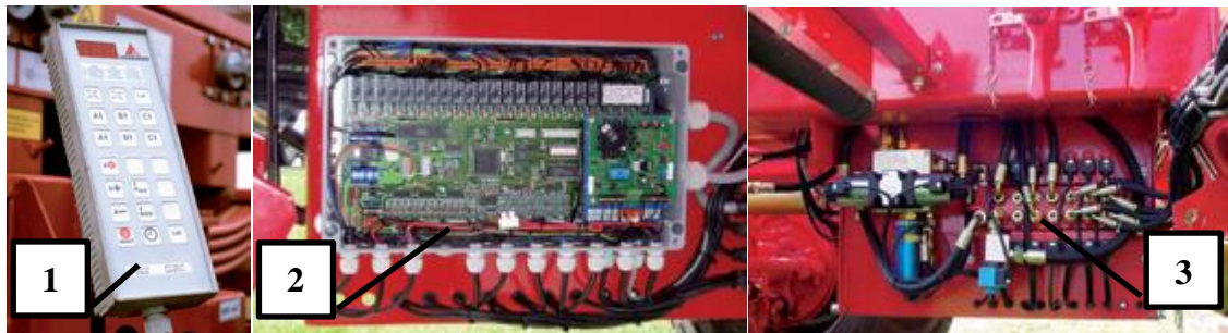
Obrázek 5-25 Elektro hydraulická soustava: 1. Ovládací pult AMS 2, 2. Rozvod elektrické soustavy, 3. Rozvod hydraulické soustavy po podvozku (2).
