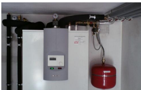
Foto. č. 5.: Tepelné čerpadlo země/voda; detailní zobrazení zapojení TČ.
