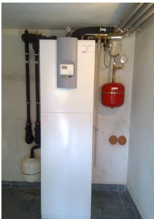
Foto. č. 4.: Tepelné čerpadlo země/voda vnitřní řešení instalace tepelného čerpadla a komponentů.
