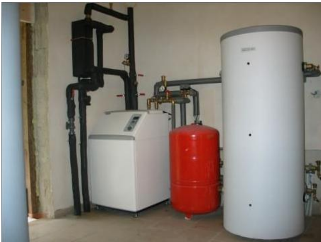
Foto. č. 8.: Rodinný dům v Lánově; Tepelné čerpadlo voda/voda, řešení umístění TČ
