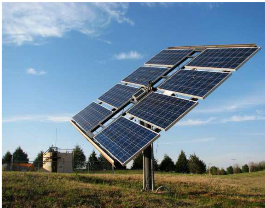
Obrázek 3 Fotovoltaický panel na trackeru
