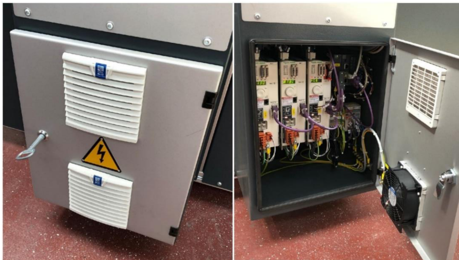
Obr. 23: Znárodnění činnosti kontrola konektorů a rozvodů v elektrorozvaděči automatického výměníku palet pomocí obrázků
