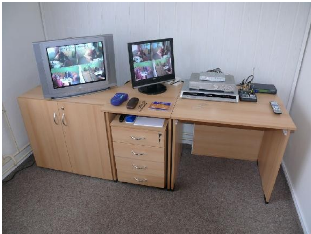
Obr. č. 3 Technická místnost
