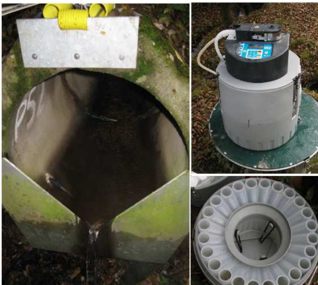
Obr. č. 14: Umístění sací hadice vzorkovače ISCO v trubním propustku Thomsonova typu vlevo. Vzorkovač ISCO od firmy Technoaqua vpravo nahoře a vpravo dole sada 24 kusů vzorkovnic ze spodní části vzorkovače. Zdroj: (KVÍTEK A KOL., 2008)
