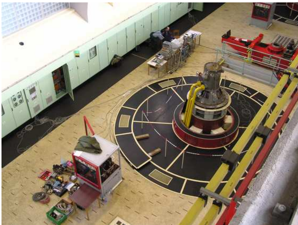
Obr. 20 Pohled na strojovnu, foto autor
