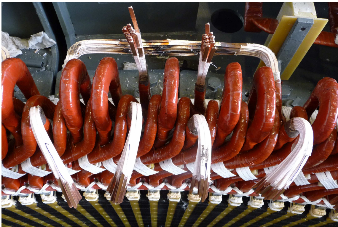
Obr. 6 Pospojování cívek vinutí generátoru, foto autor
