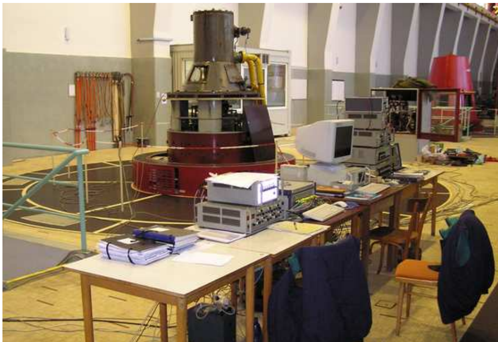
Obr. 21 Umístění měřící techniky ve strojovně, foto autor
