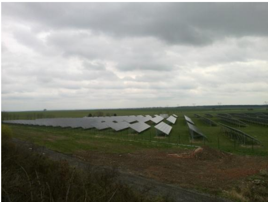
Obr. 13 Severní část východního bloku FV elektrárny Ševětín, autor Jan Trnobranský, 8. 4. 2012
