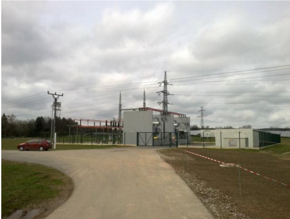
Obr. 10 Elektrorozvodna FV elektrárny Ševětín (západní blok) , autor Jan Trnobranský, 8. 4. 2012
