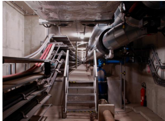
Obrázek 19: Potrubí v podzemních kolektorech, [52]
