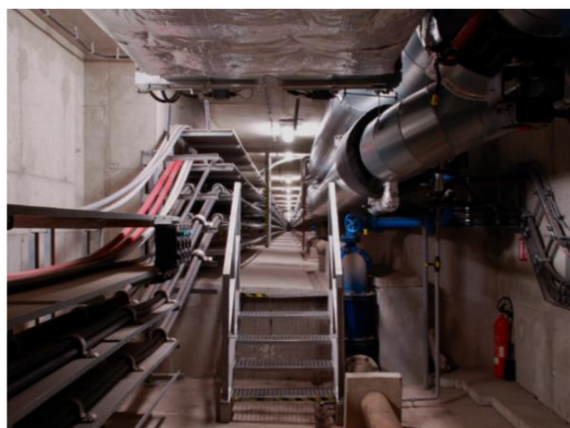
Obrázek 19: Potrubí v podzemních kolektorech, [52]
