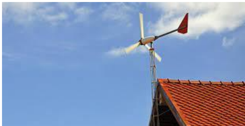
Obrázek 3 - Malá větrná elektrárna
