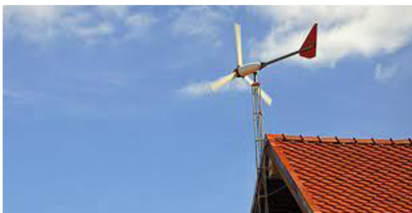
Obrázek 3 - Malá větrná elektrárna
