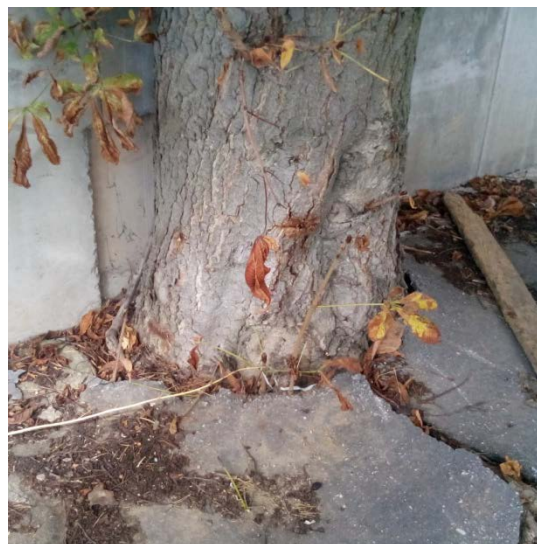
Obrázek 7 ořešák v ulici Na Vrchmezi s nulovým vsakovacím prostorem
