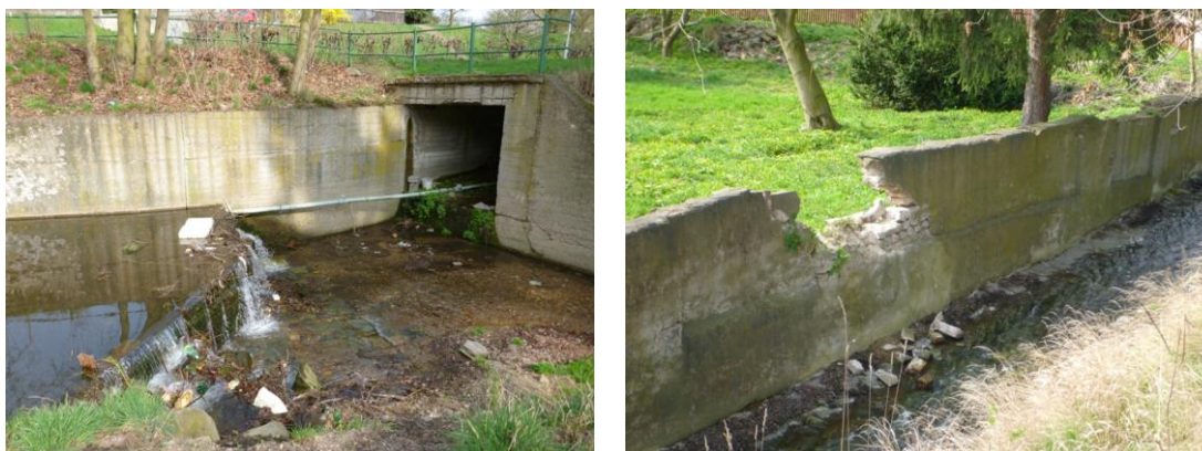
obr. č. 63, 64 Znečištění potoka u rozdělovacího objektu a poškození opěrných zdí podél toku (Šíma 2014).
