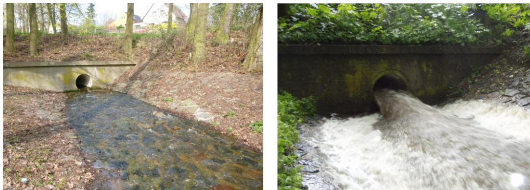
obr. č. 46, 47 Odtok za rozdělovacím objektem (Šíma 2014; 2013).
