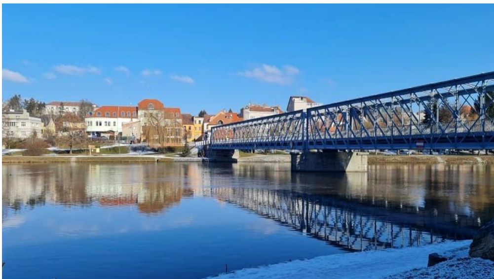
Obr. 3: Pohled na železný most roku 2021 v Týně nad Vltavou (autor: vlastní terénní šetření, 2021).
