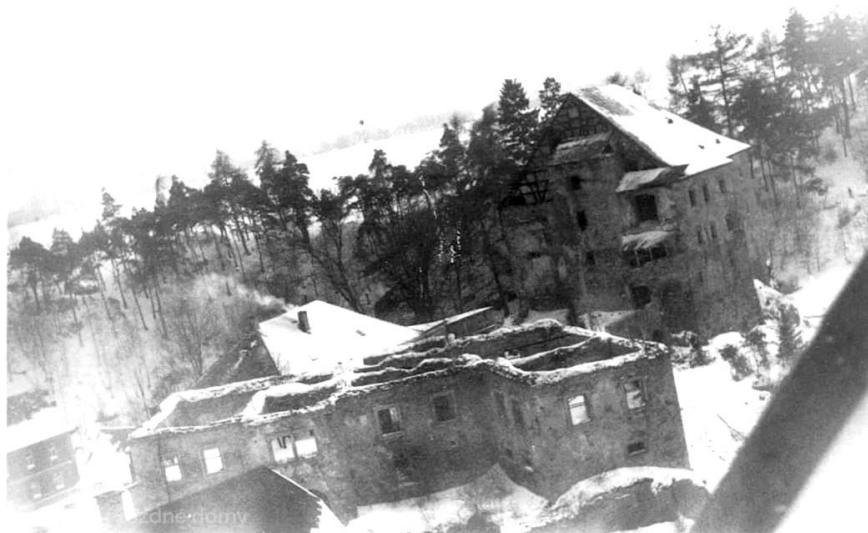
Obrázek 9: Hrad Vildštejn v havarijním stavu (Prázdné domy, 2020) (URL 7)
