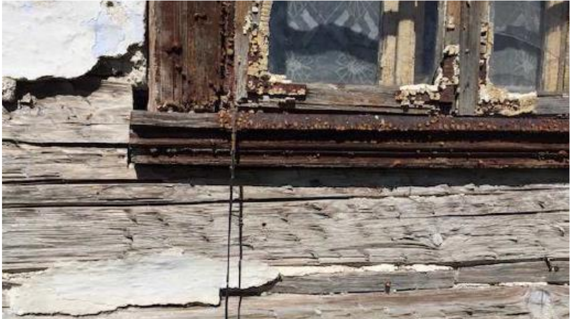
Obr. 49 Detail poškození okna (foto vlastní, 2016)
