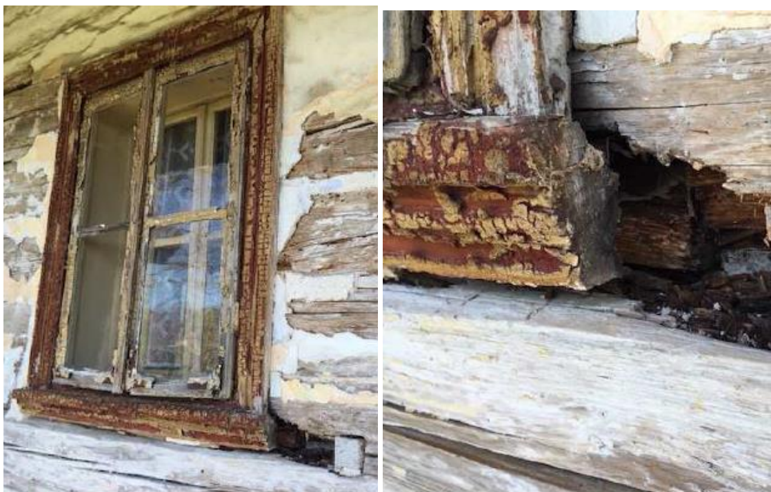
Obr. 63 Detail poškození u okna v roubené stěně označené číslem 1 (foto vlastní, 2016)
