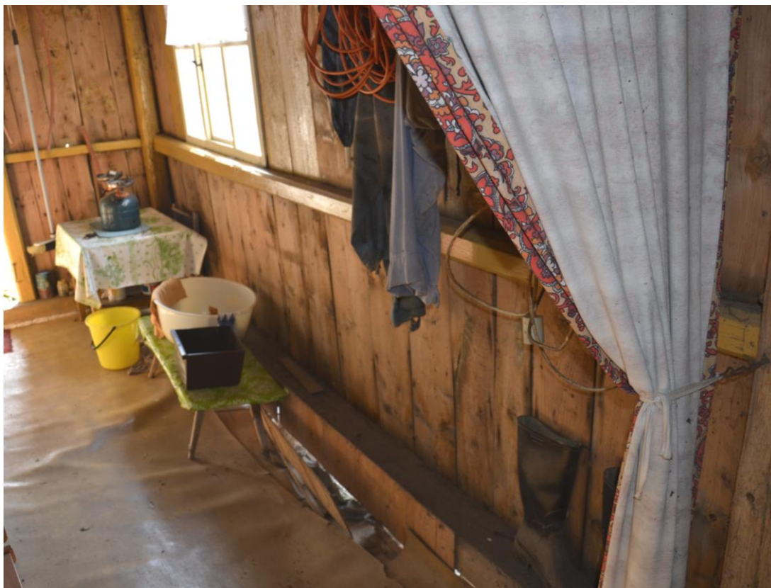
Obr. 58 Propadlá a nerovná podlaha v jihozápadním podsínku, hned za vstupními dveřmi (foto vlastní, 2016)
