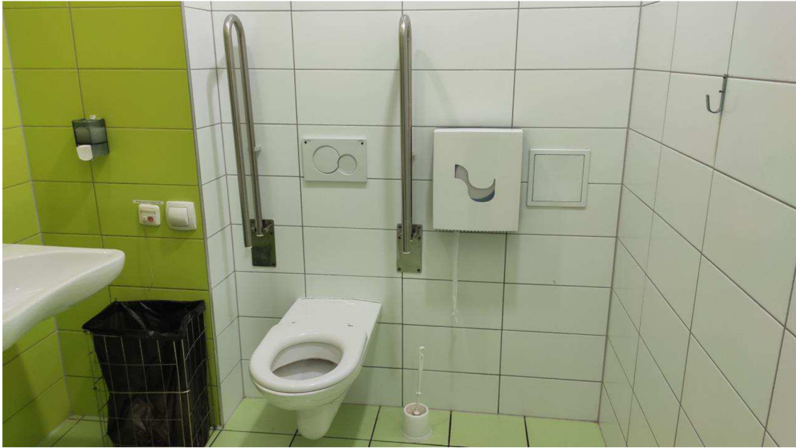
Obr. 34 – Místnost toalety se zařizovacími předměty
