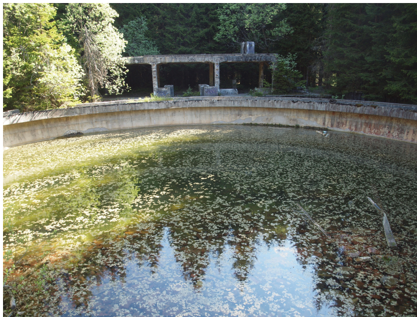
Obrázek 47: Úpravna Sauersrack. Vodní nádrž (URL 47)
