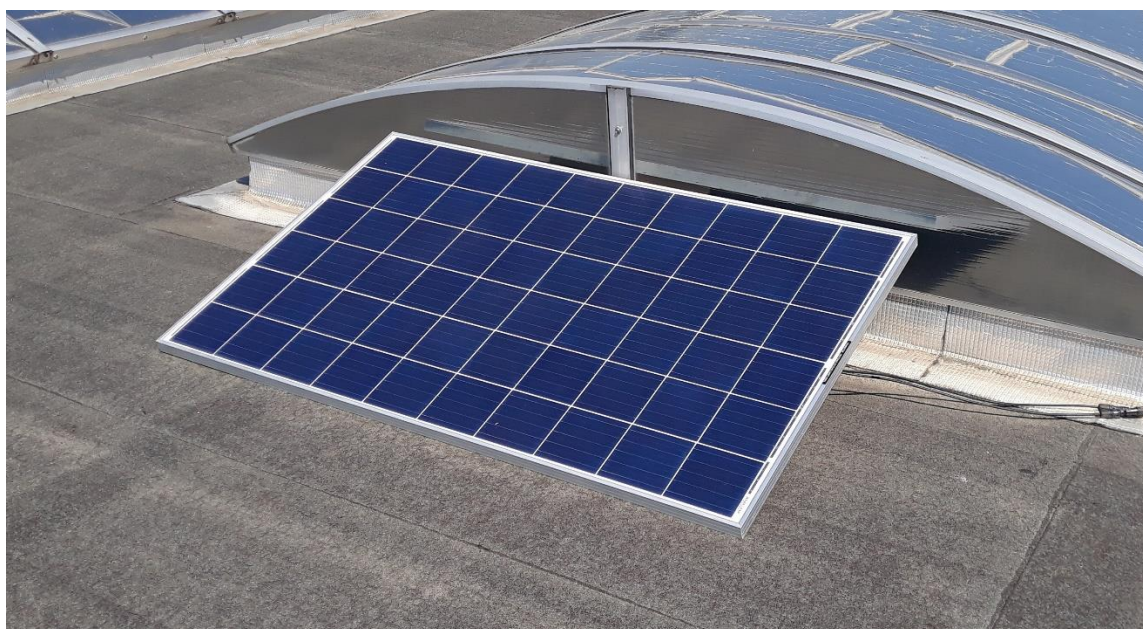
Obr. 2.4 Umístění FV panelu na střeše firemní budovy
