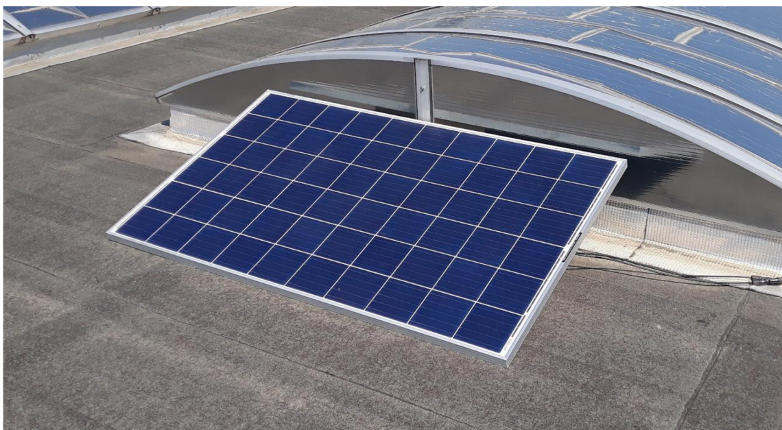
Obr. 2.4 Umístění FV panelu na střeše firemní budovy
