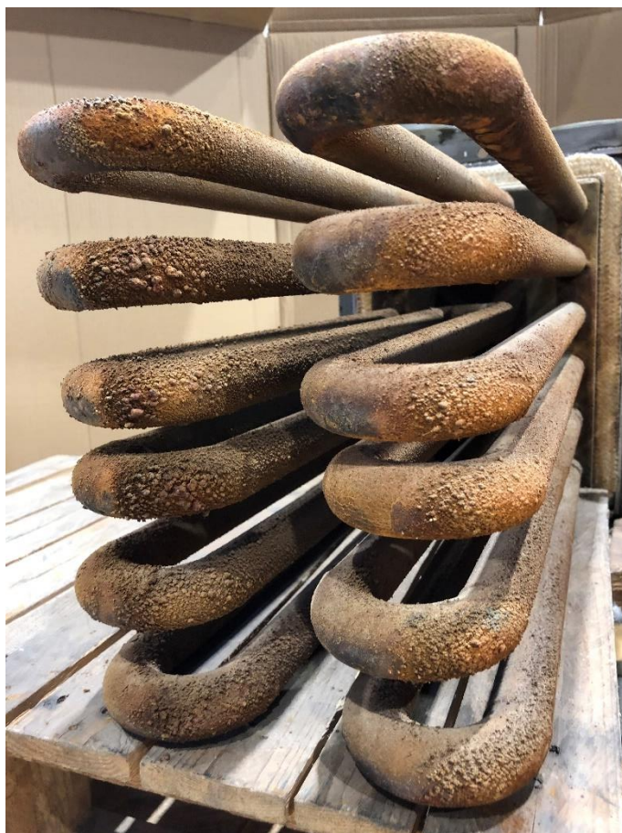
Obr. 61 Stav posledního segmentu chladiče spalin po spalovacích zkouškách (směr proudění spalin byl zprava doleva)
