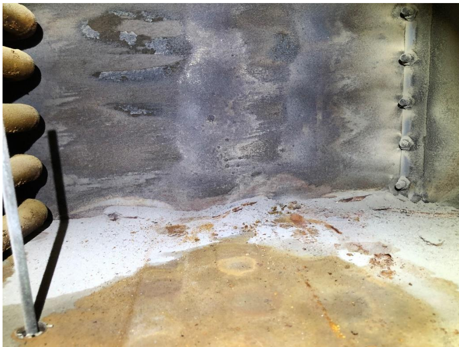
Obr. 60 Stav chladiče spalin po spalovacích zkouškách (směr proudění spalin byl zleva doprava)
