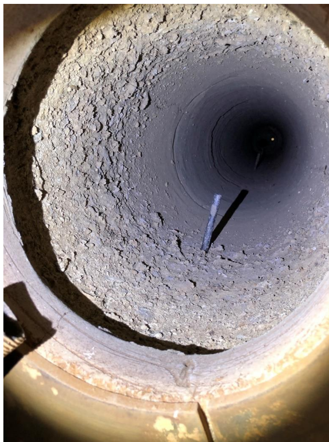
Obr. 45 Nápeky ve vstupní části pece po spalovací zkoušce s MIX 2 – 4
