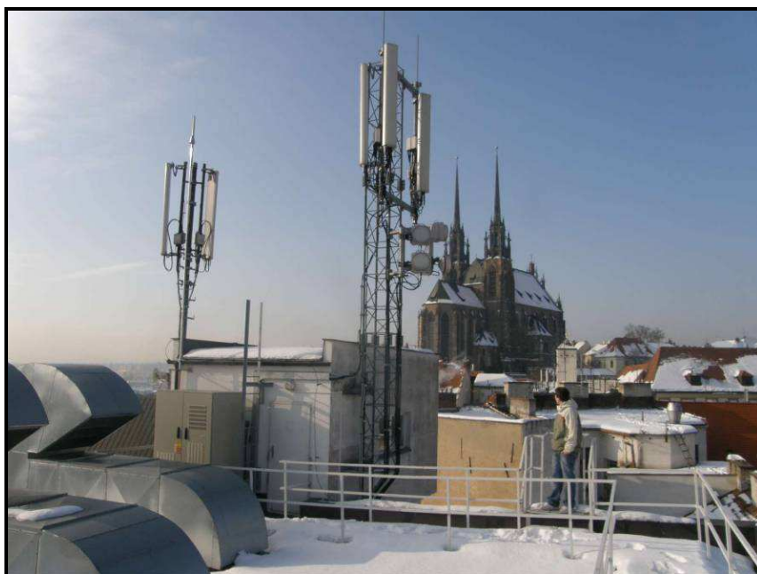
Obr. 4.6 Základnová stanice na střeše budovy
