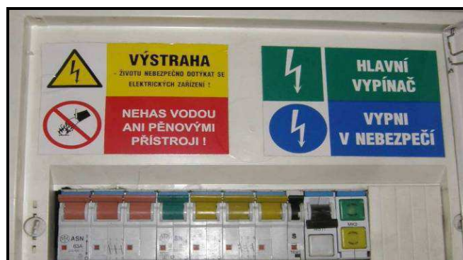
Obr. 3.13 Příklad značení elektrického rozvaděče.
