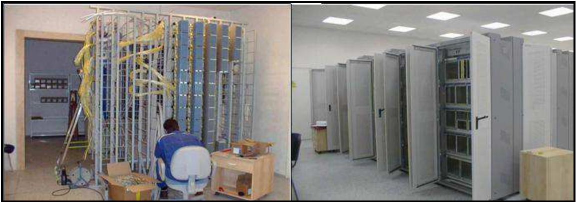
Obr. 4.7 Technologické místnosti datového centra.
