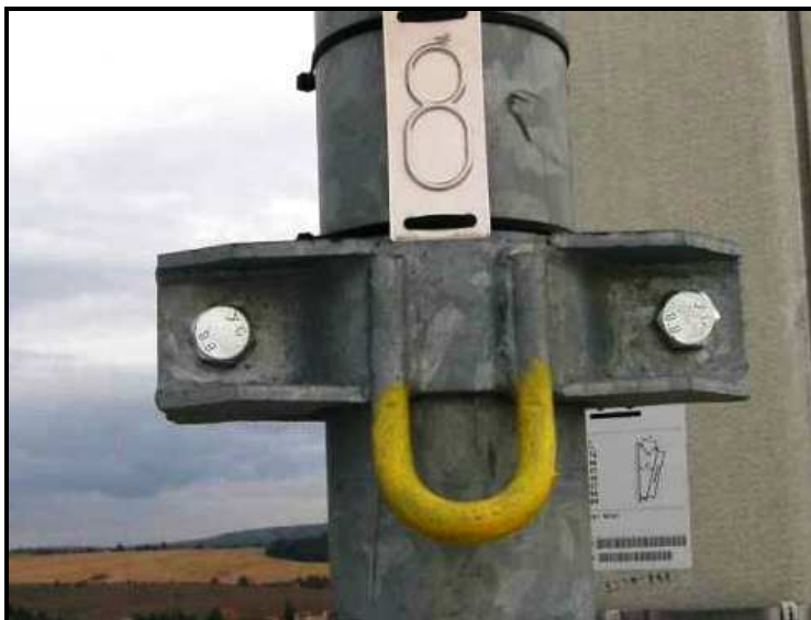
Obr. 6.4 Dříve užívaný kotevní bod na stožáru.
