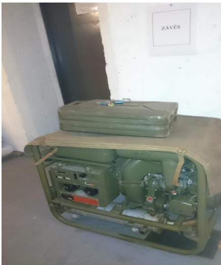
Obrázek č. 9: Záložní generátor Foto: autor DP
