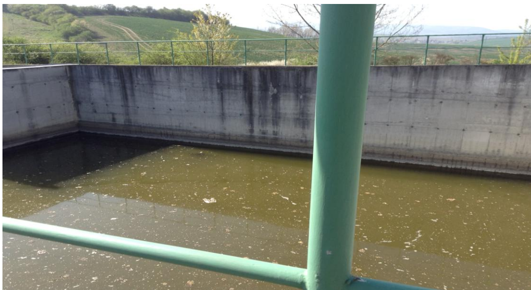
Obr. č. 6 Jímka průsakových odpadních vod (Ciencialová, 2016)
