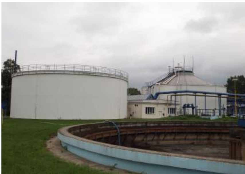
Obr. č. 20 - Uskladňovací nádrž kalu, vyhnívací nádrž (Štěpán Satina, 2016, in. litt)
