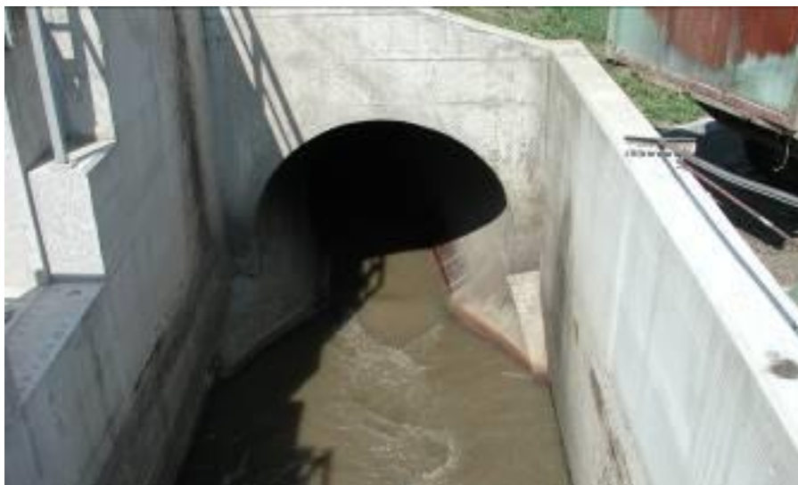
Obr. č. 12 - Přítok na ČOV (vlastní)
