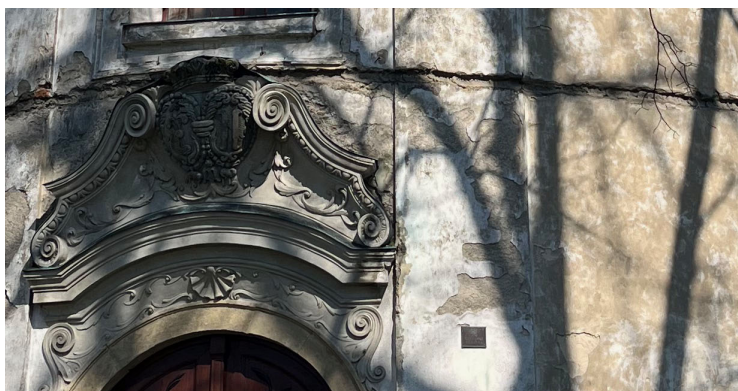
Obr. 5 Rýmařov, fasáda kostela poškozená ocelovými lany, kostel Navštívení Panny Marie, západní strana kostela
