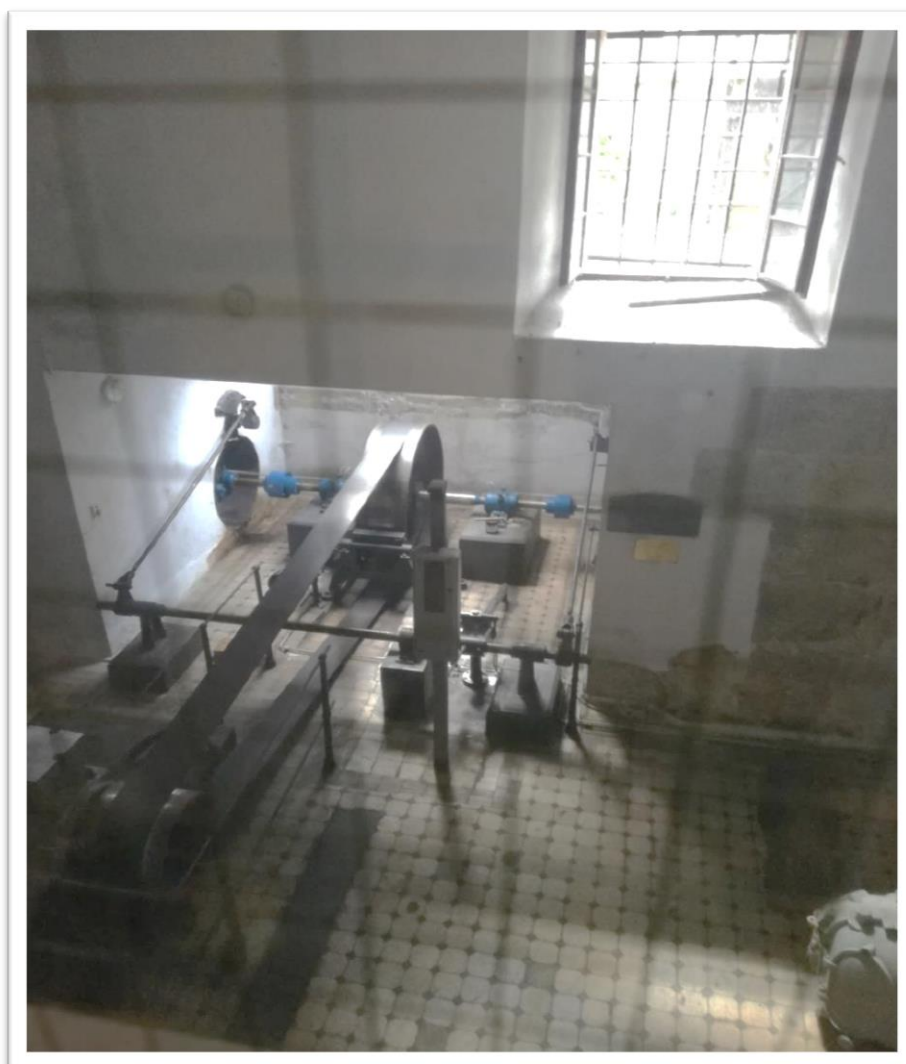
Obrázek č. 20: Křížíkova vodní elektrárna Jindřichův Hradec s Francisovými turbínami Zdroj: archiv autorky
