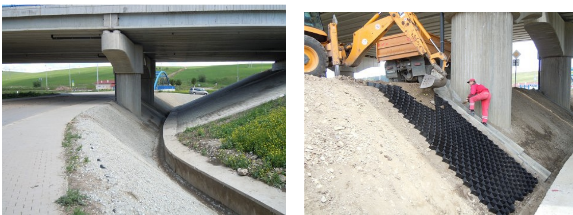
Obr. 40: Protierozní opatření odvodňovacího příkopu (GEOMAT, ©2021b).
