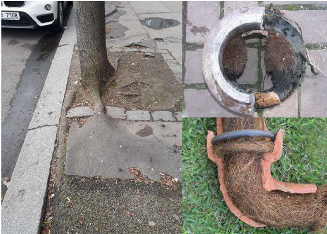
Obrázek 16 Narušení městské infrastruktury kořenovým systémem 62
