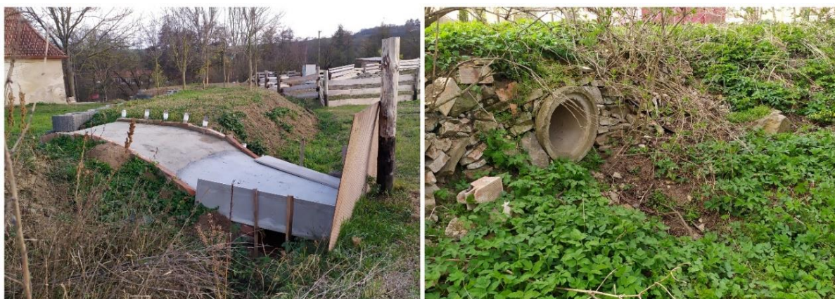
Obr. 18 – Stavební úpravy na tělese příkopu (vlevo) a vyústění do recipientu (vpravo), (zdroj: vlastní)
