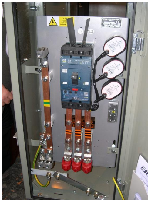
Obr. 36- Příklad umístění omezovačů přepětí NN v rozvaděči NN distribuční trafostanice.[24]
