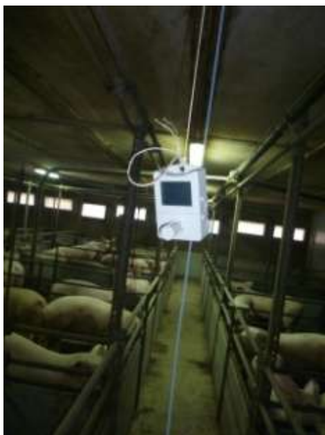
Obrázek č. 10 Umístěný měřicí přístroj LOGGER S3120
