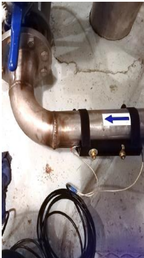
Obrázek 8 Umístění snímače průtoku na chladícím potrubí
