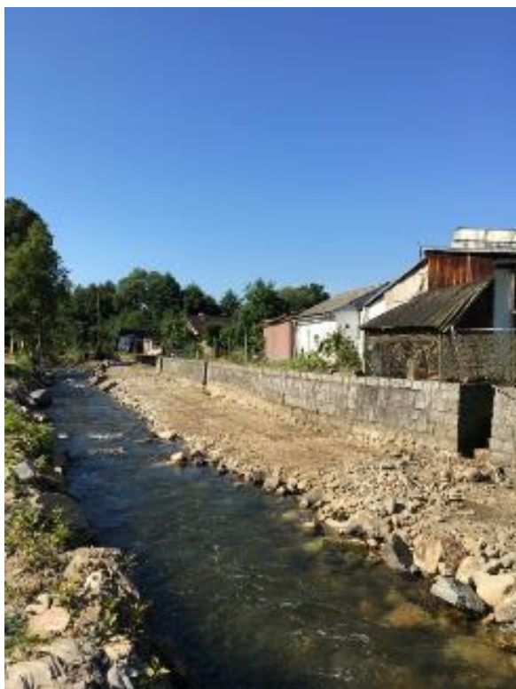
Obrázek 24: Nevyhovující nábřežní kamenná zed' (Jílková 2019).
