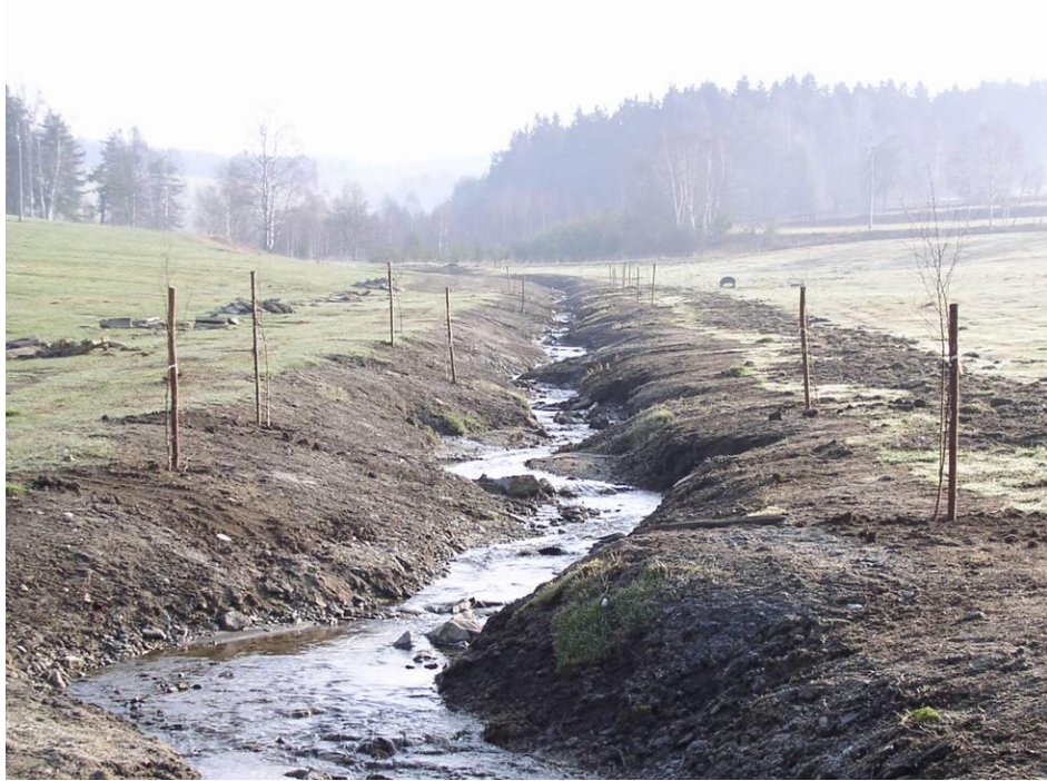
Příloha 11 a: Průběh revitalizace na Sviňovické strouze, nad silnicí a pod silnicí, stav těsně po dokončení v době výsadby stromů, zdroj: Simon et al., 2018.
