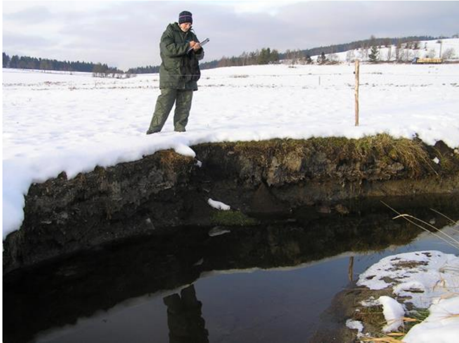
Příloha 13 a: Zbytinský potok – zpevnění erodujícího koryta haňošterkovými válci – silně erodovaný břeh prosinec 2005, zdroj: Simon.
