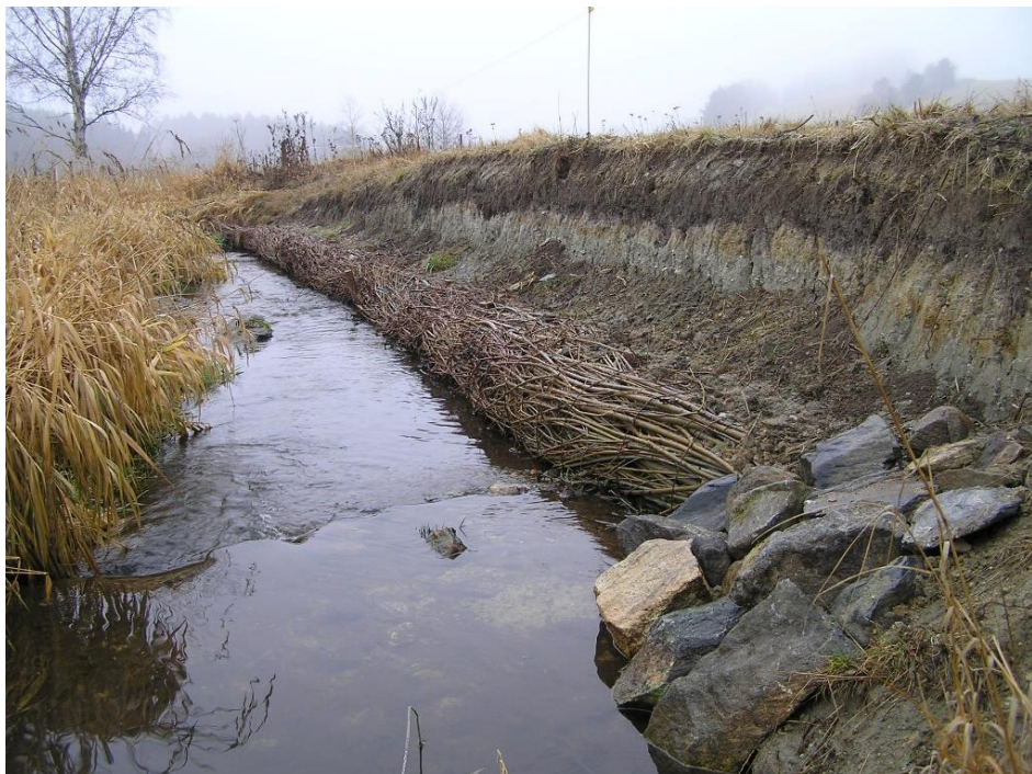
Příloha 13 b: Zbytinský potok – zpevnění erodujícího koryta haňošterkovými válci – válec z živého proucí těsně po instalaci listopad 2006, zdroj: Simon.
