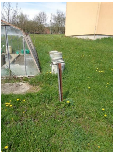
Obr. 20. Vodovod na zalévání (foto Diana Konečná, 2021)
