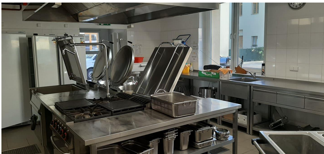
Obrázek 11 - Nové gastro vybavení kuchyně
