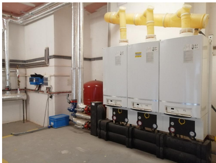
Obrázek 8 - Kotelna v základní škole
