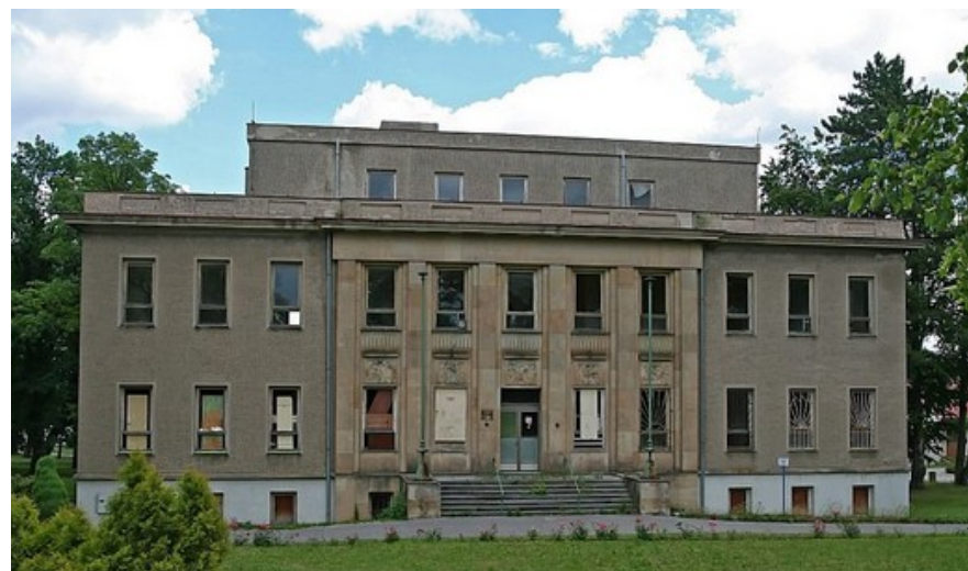
Obr. 60: Honosná úprava fasády staré budovy nemocnice jí sjednotila s budovou novou. Dnes rychle chátrá po propadu střechy.
