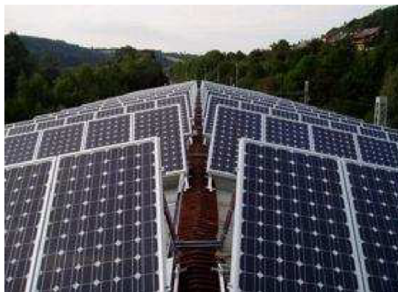
Obr. 5: Fotovoltaické moduly instalované v Brněnci u Svitav [16]
